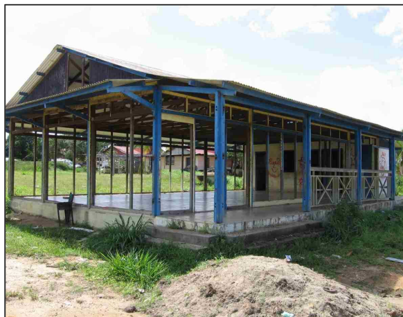
Ancienne maison de quartier délabrée
